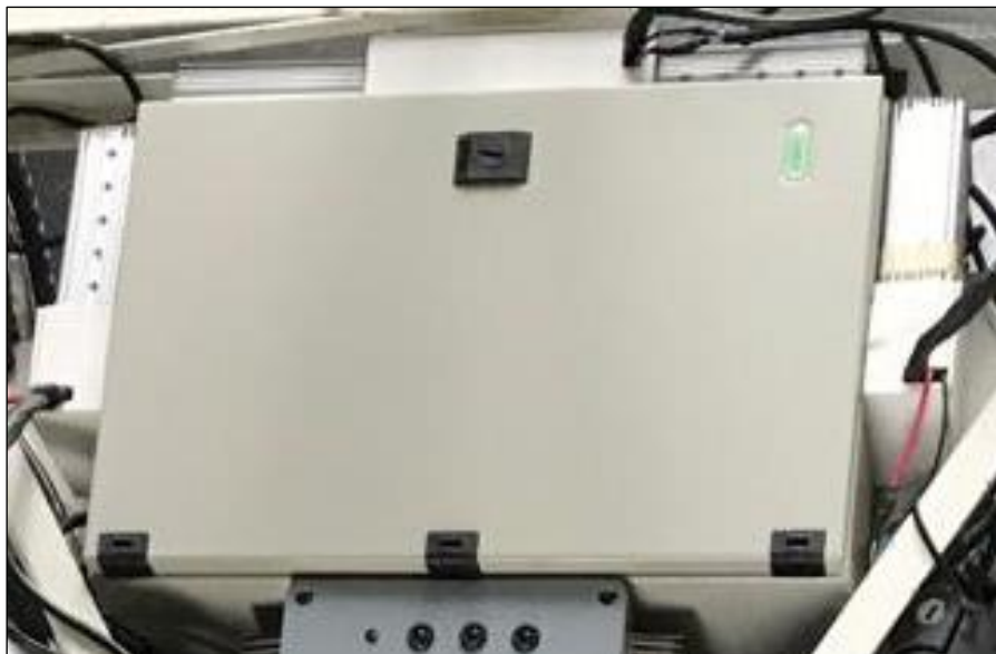
Figura 9.11: Cajas y drivers montados sobre el gabinete.
